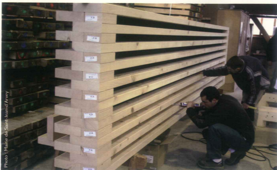
Les planchers sont constitués de planches de 220 x 50 mm de section, disposées verticalement en quinconce et assemblées par des vis de 180 mm de longueur.
